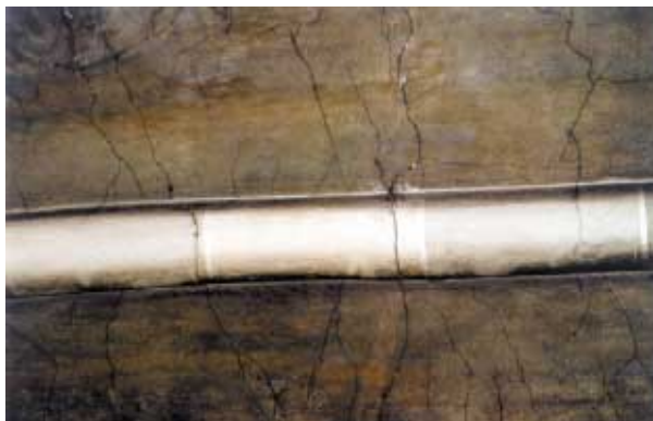
Fot. 5. Zarysowania żebra A-B-C w punkcie B. Widoczne zarysowania żebra przechodzące w sklepienie
