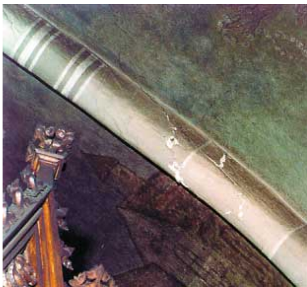
Fot. 7. Zmiażdżenie części żebra w punkcie 1
