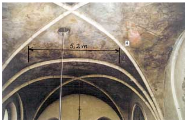
Fot. 13. Strefa zginania sklepienia
