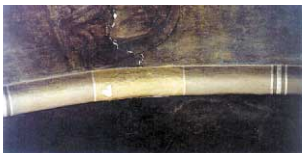
Fot. 8. Zmiażdżenie części żebra w punkcie 2 i przypowierzchniowej warstwy sklepienia
