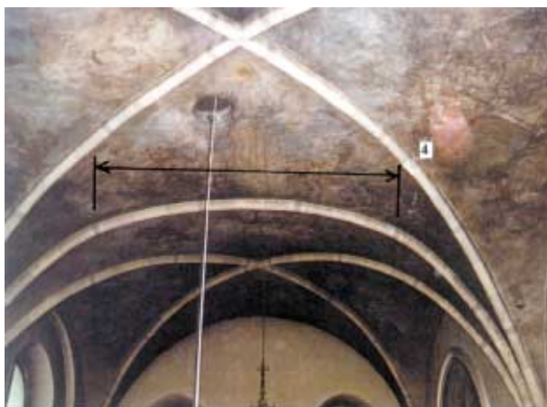
Fot. 3. Spłaszczenie środkowego pasma sklepienia
