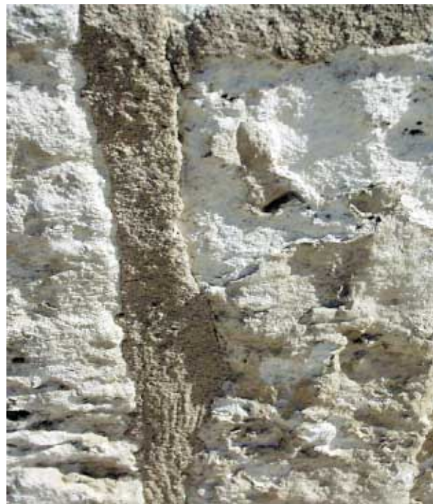
Rys. 18. Solne wykwity na powierzchni wapienia
