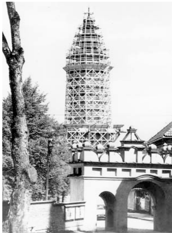
Rys. 11. Wieża ratuszowa w rusztowaniach w 1998 r. Fot. T. Ślawnicki. Wg Ślawnicki T., Biecz , 1999-2000
