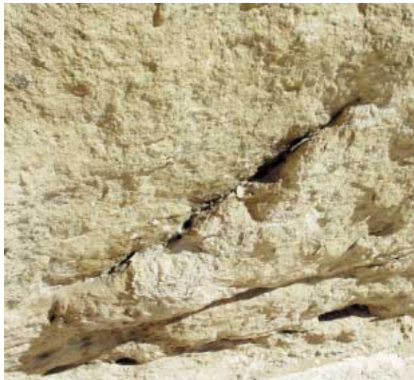
Rys. 20. Głębokie pęknięcia strukturalne
