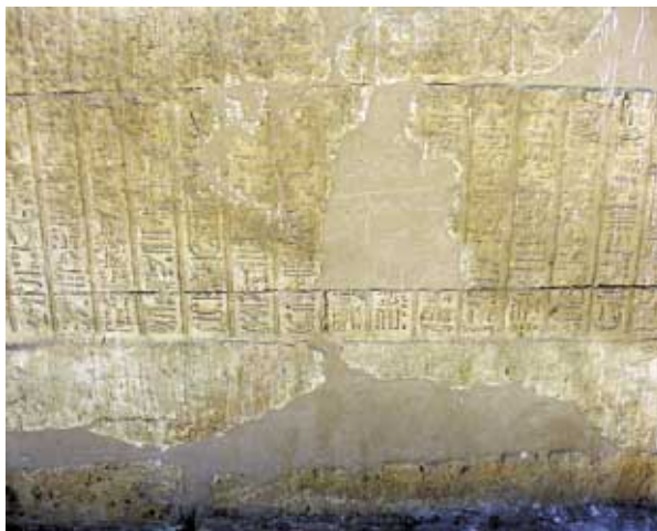
Rys. 21. Nieudane próby wcześniejszej konserwacji
