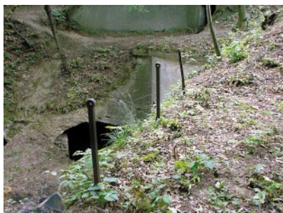
Ryc. 7. Zachowane słupki barierek ochronnych
