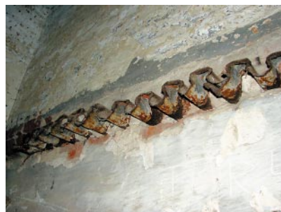
Ryc. 11. Stropowa blacha fałdowa
