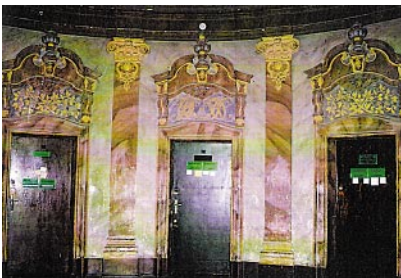
Ryc. 3. Neobarokowe wnętrze klatki schodowej – stan przed konserwacją Fig. 3. Interior of the Neo-Baroque staircase – before conservation
