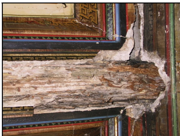
Rys. 7. Zniszczenia belek konstrukcyjnych kasetonów w Dużym Pokoju Chińskim
