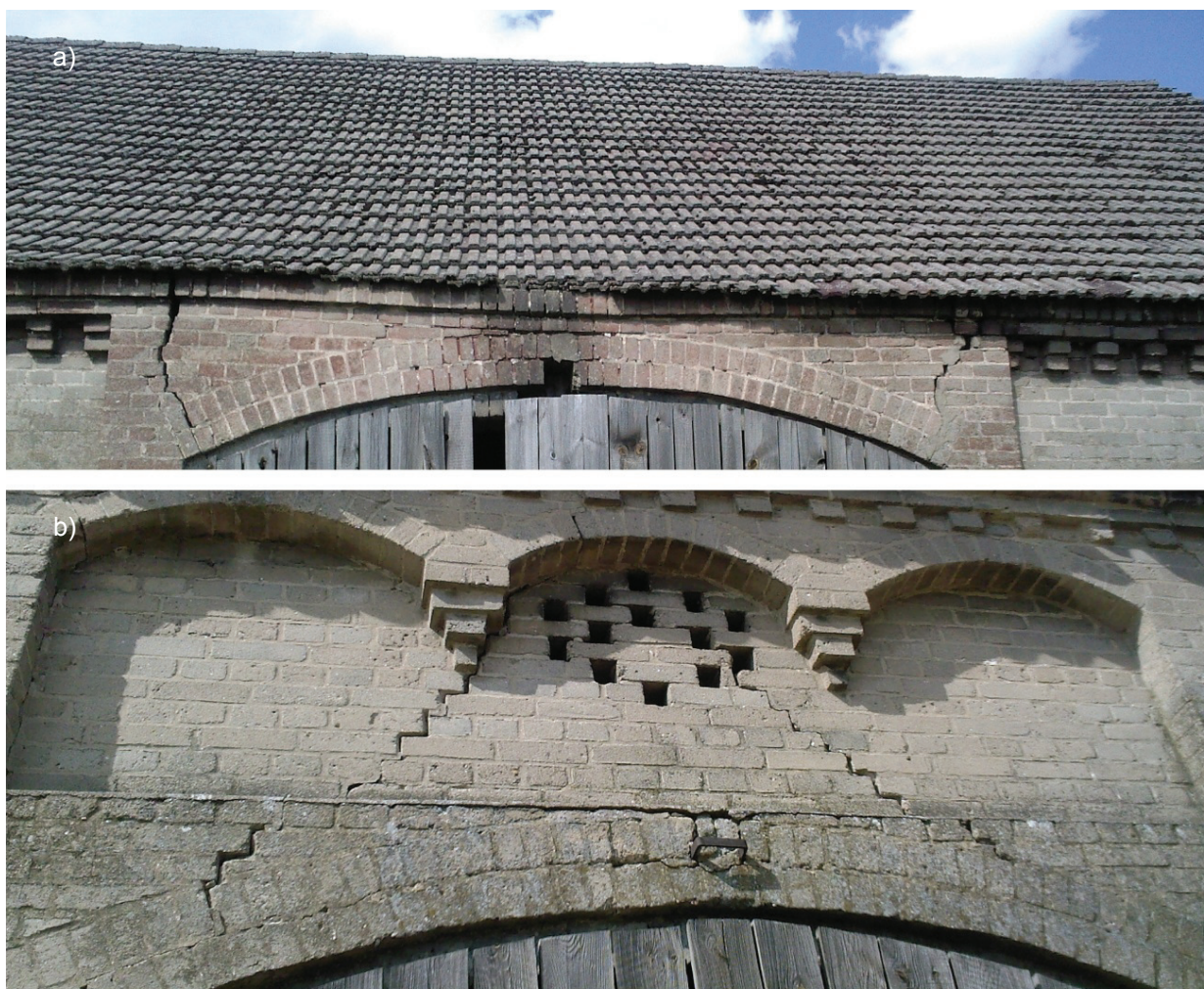
Rys. 4. Zniszczenie ceglanego nadproża łukowego z uwagi na: a – powstanie ustroju trójprzegubowego, b – powstanie wtórnego łuku Fig. 4. Damage of brick, arched lintels' construction because of: a – triple-hinged framework, b – derivative arch
