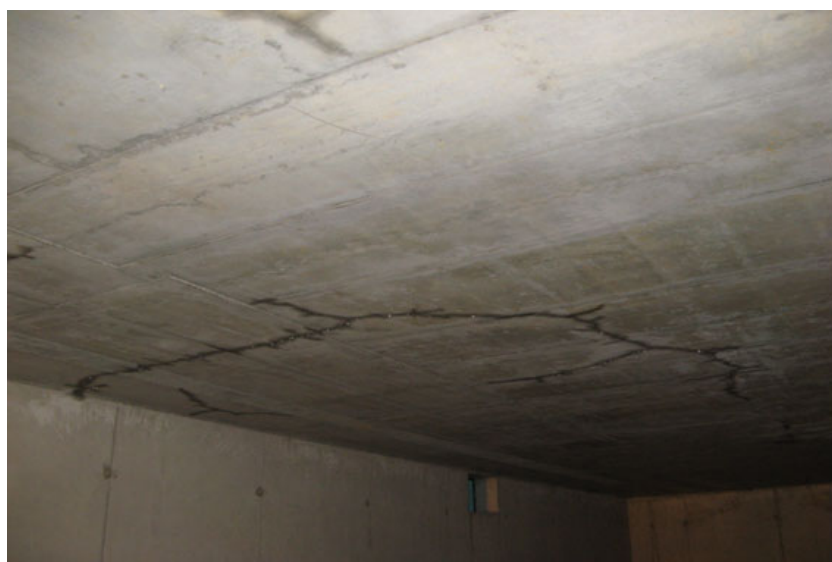
Rys. 5. Widok rozwiniętej rysy o układzie wielokierunkowym Fig. 5. Cracks on the bottom floor area
