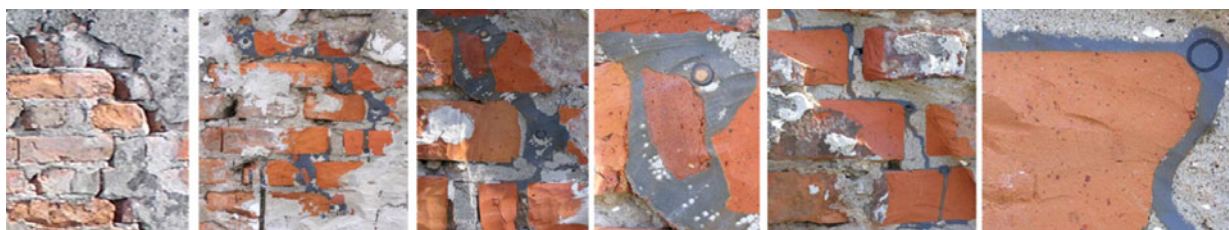
Rys. 3. Polimerowe złącze podatne wykonane w pękniętym budynku murowanym z cegieł Fig. 3. Polymer flexible joint constructed in a cracked masonry building
