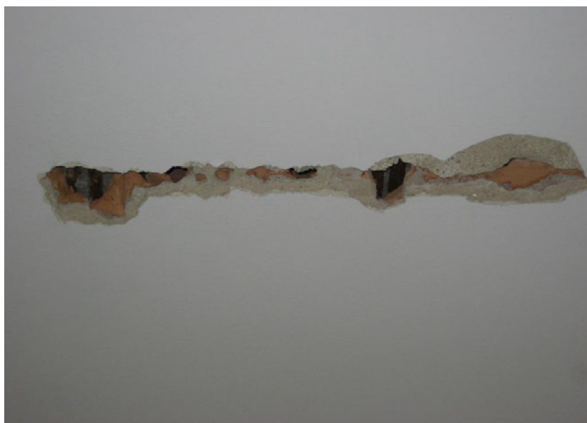
Rys. 3. Okrywka konstrukcyjna zbrojenia stropu Fig. 3. Stripping of the ceiling slab reinforcement
