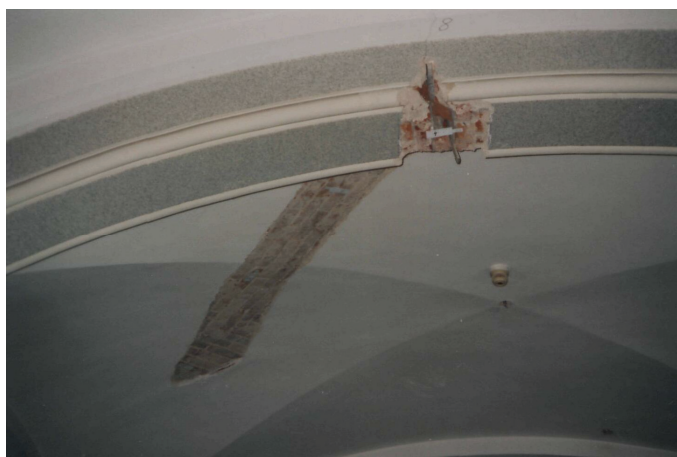
Rys. 3. Widok spękanego łuku A i części sklepienia nr 4 Fig. 3. View of the cracked arch A and part of vault no. 4
