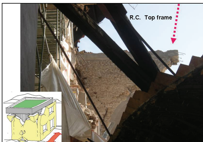
Fig. 10. Top reinforced concrete beams can give negative effects Rys. 10. Belki żelbetowe na górze budynku mogą mieć negatywne skutki
