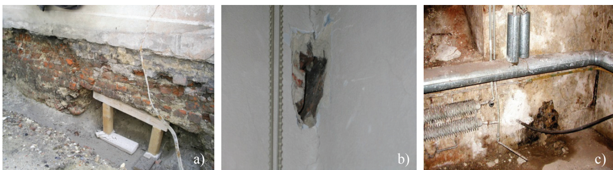
Rys. 4. a) zagłębienie fundamentu, b) rozwarście ścian w narożach, c) zawilgocenia piwnic Fig. 4. a) the depression of the foundation, b) opening in corners of the walls, c) rising damp of the cellars
