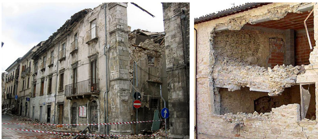
Fig. 1. Example of out-of-plane collapse (left); out-of-plane collapse of a wall with r.c. tie beams (right) Rys. 1. Przykład zawalenia się pozapłaszczyznowego (z lewej strony); pozapłaszczyznowe zawalenie się ściany ze ściąganiem z belki żelbetowej (z prawej strony)
