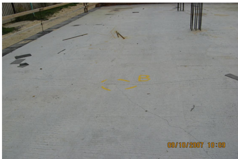
Rys. 4. Układ rys na górnej płaszczyźnie stropu Fig. 4. Cracks on the upper floor area
