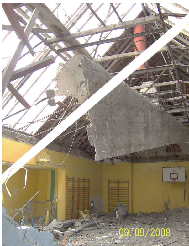
Rys. 3. Widok sufitu sali gimnastycznej przed katastrofą Fig. 3. View of the gymnasium's ceiling before the catastrophe
