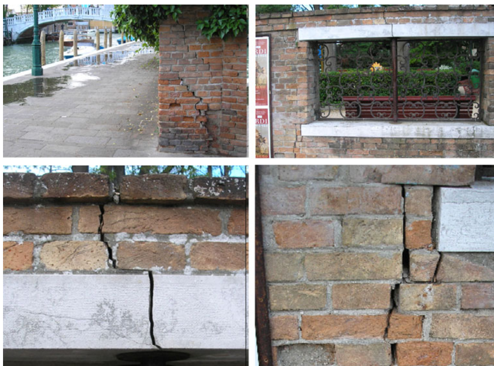
Rys. 4. Pęknięty mur w Wenecji, odpowiedni do naprawy polimerowym złączem podatnym Fig. 4. Cracked masonry wall in Venice, adequate for injection using of polymer flexible joint
