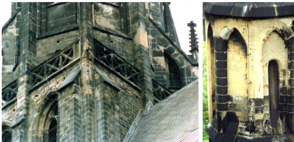
Rys. 9. Uszkodzenia elewacji Kościoła Mariackiego w Katowicach Fig. 9. Damage of the church facade
