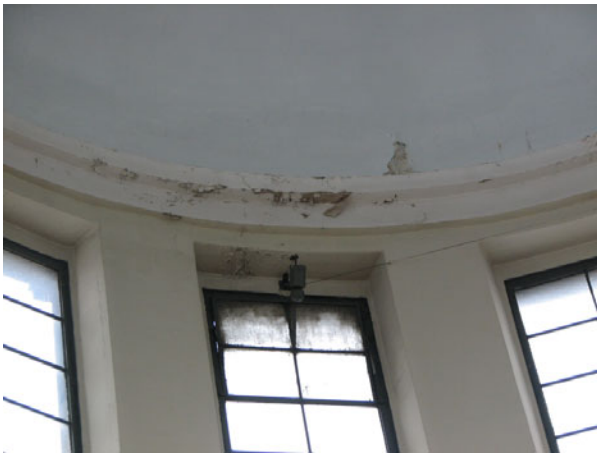
Rys. 7. Skrzydło południowe. Widok od dołu fragmentu kopuły kołowej. Widoczne ślady po przeciekach i rozwój grzybów pleśniowych Fig. 7. Southern wing. View of a fragment of circular dome. Visible traces caused by leakage and mildew fungus growth
