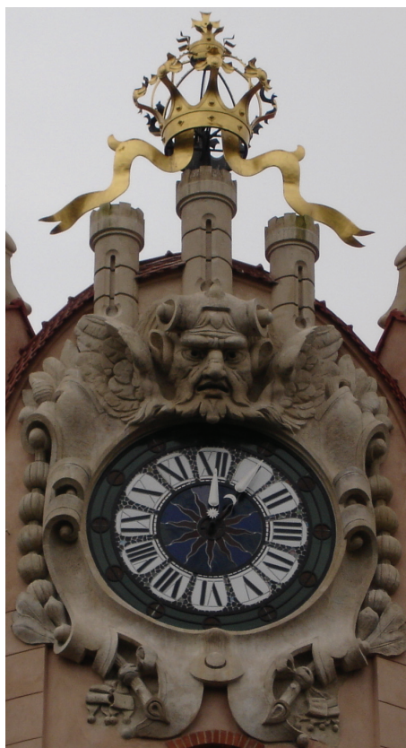
Rys. 2. Fragment dekoracji fasady dawnej Akademii Handlowej w Krakowie, odrestaurowanej za pomocą cementu romańskiego Fig. 2. Part of the decoration of former Trade Academy in Cracow facade, renovated with Roman cement
