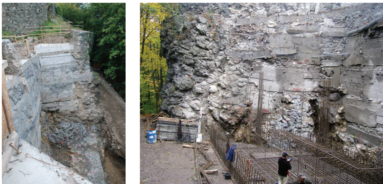
Rys. 7. Wzmocnienie skarpy oraz pierwsza faza wykonania zbrojenia odtwarzanego fragmentu murów obwodowych zamku (konstrukcja żelbetowa)
