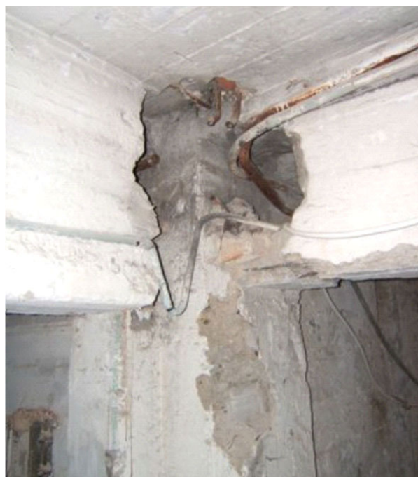
Rys.7 Przekucia przez nadproża Fig. 7. Holes hammered through a lintel
