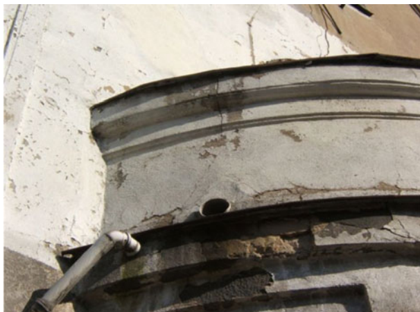
Rys. 4. Zawilgocenia, spękania na elewacji Fig. 4. Moisture deposits and cracks
