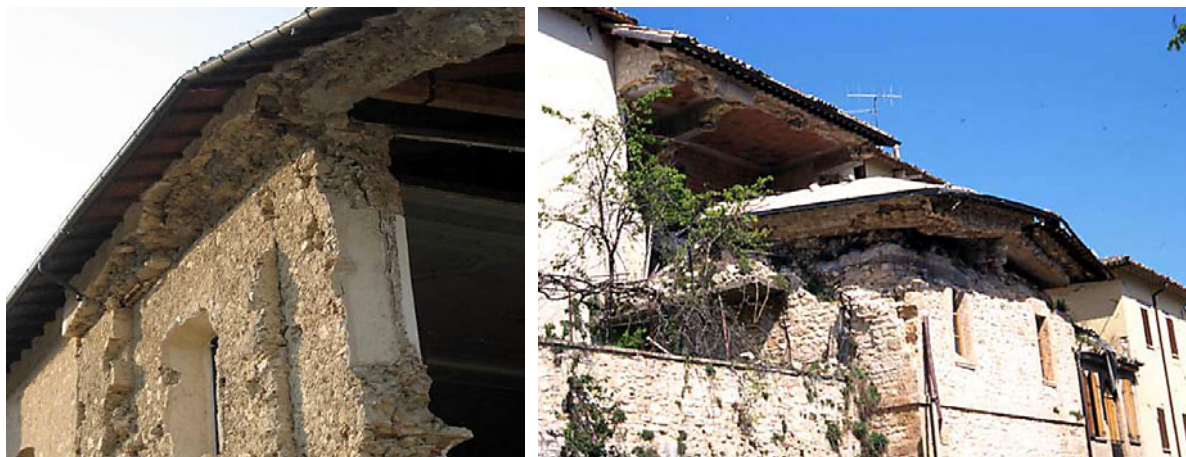
Fig. 2. R.C. roof pounding the masonry walls Rys. 2. Żelbetowy dach rozbijający murowane ściany
