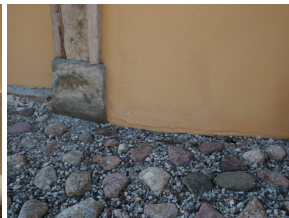
Rys. 4. Tynk renowacyjny nie powinien stykać się z gruntem, należy tam pozostawić szczelinę
