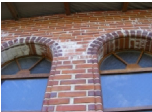
Rys. 1. Wykwit na współczesnym murze licowym Fig. 1. Efflorescence on present facing wall
