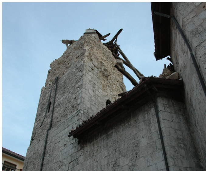
Fig. 5. The mechanism of “de-foliation” on the top of the tower trunk caused the rigid sliding of the Bell-Cell on the soil Rys. 5. Mechanizm “defoliacji” u góry trzonu wieży spowodował sztywne osunięcie się celi dzwonowej na ziemię
