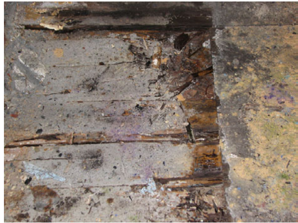
Fot.6. Skrzydło północne. Widok porażenia desek podłogowych przez grzyba domowego właściwego Fig. 6. Northern wing. View of wooden floor damages caused by house fungus
