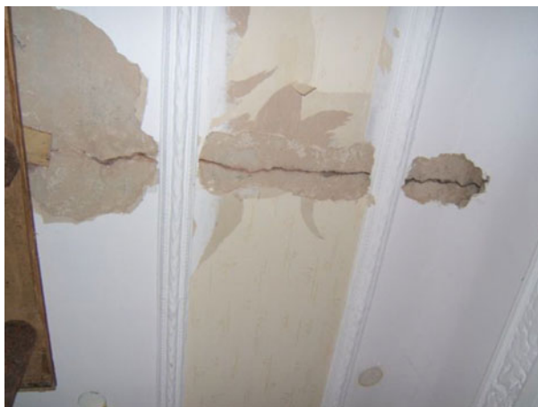
Rys.6 Pęknięcie stropu Akermana Fig. 6. Crack of Ackerman floor
