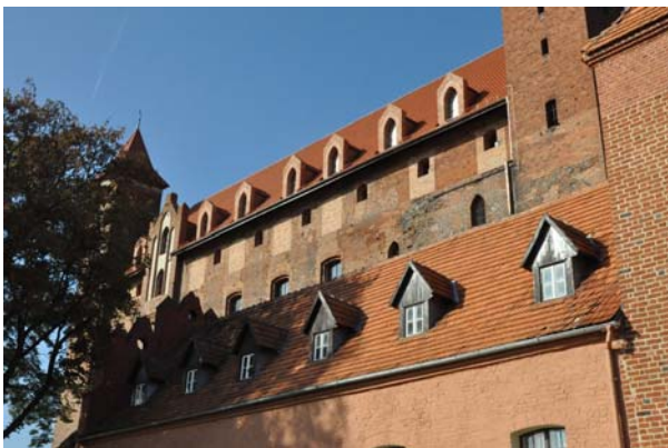
Ryc. 2. Zrekonstruowane lukarny w zewnętrznych połaciach dachowych, gdzie docelowo zostanie zrealizowana kondygnacja hotelowa (materiały autora)
