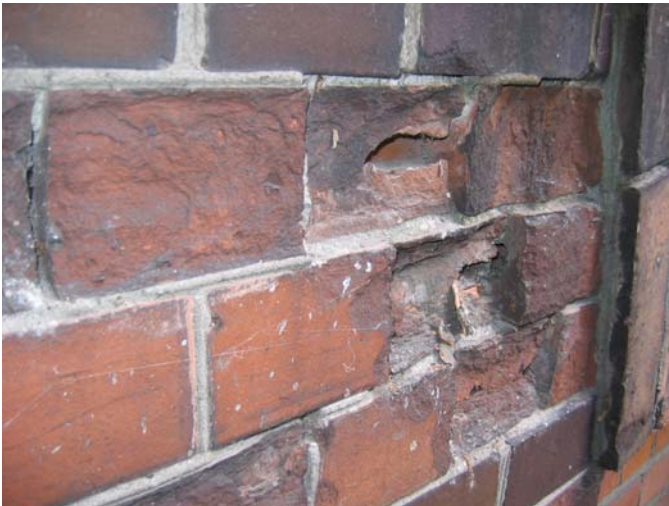
Ryc. 4. Strefa przyziemia, ubytki cegieł elewacyjnych powstałe w wyniku szkód mrozowych na mokrym murze Fig. 4. Basement wall. Damaged bricks in the façade caused by freezing of damp masonry
