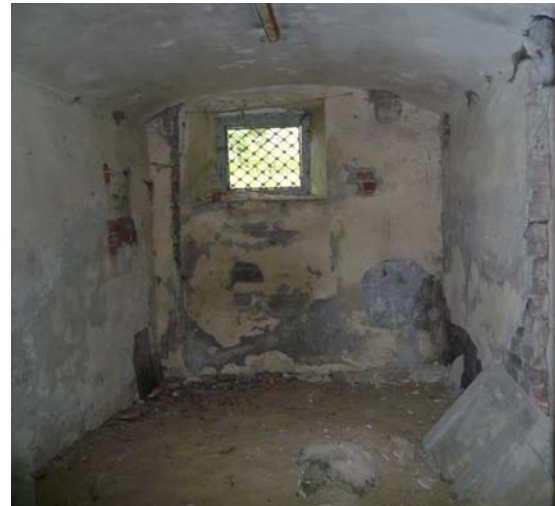
Ryc. 5. Piwnica, zawilgocenie, ubytki i naprawy tynków zaprawą cementową Fig. 5. Cellar – damp, damage and repair of plaster with cement mortar
