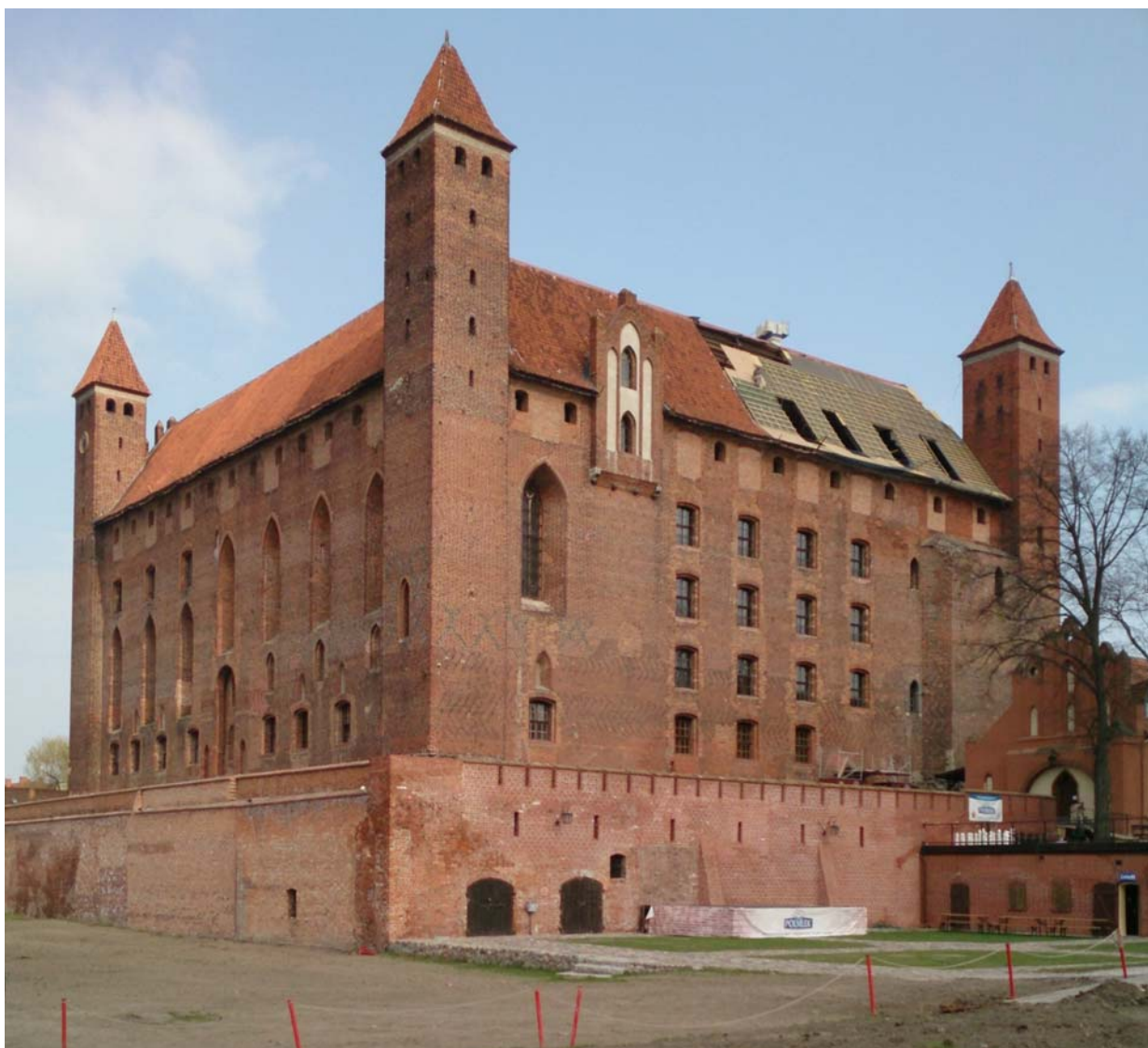
Ryc. 1. Częściowo uporządkowane otoczenie Zamku w Gniewie oraz początek prac remontowo-konserwatorskich przy wymianie pokrycia dachowego (materiały autora)
