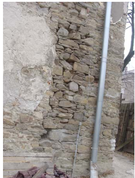
Ryc. 6. Cerkiew w Baligrodzie – wypłukany mur – listopad 2011 r. (fot. J. Kufel) Fig. 6 The Orthodox Church in Baligród – washed out masonry – November 2011 (photo J. Kufel)
