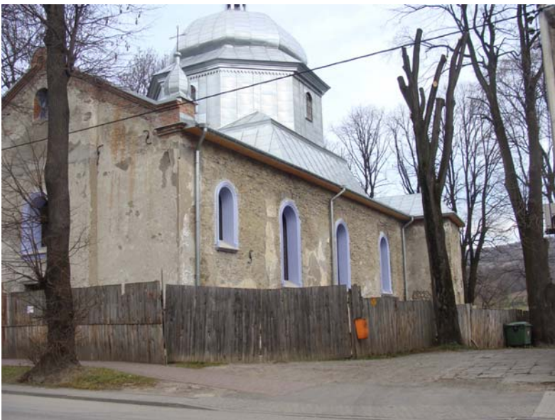
Ryc. 5. Cerkiew w Baligrodzie – zdegradowany tynk – listopad 2010 r. (fot. J. Kufel) Fig. 5 The Orthodox Church in Baligród – damaged plaster – November 2010 (photo J. Kufel)
