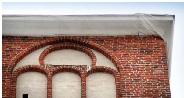
Ryc. 5. Zabezpieczenie siatką gzymsu przed spadaniem odpojonych fragmentów Fig. 5. Cornice covered with safety netting to prevent debonded fragments falling down into the street below
