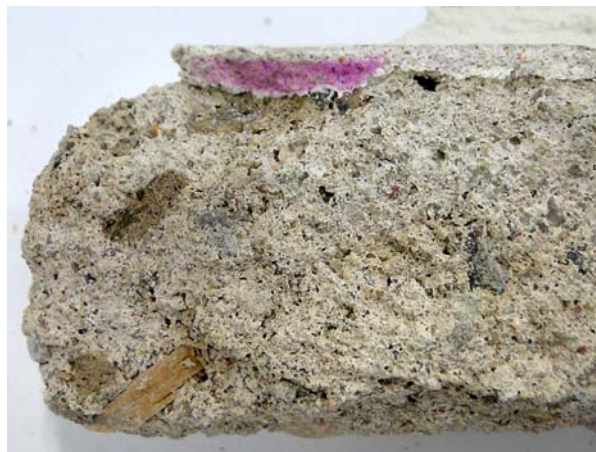
Ryc. 11. Fragment próbki nr 3. Mocno porowaty stary beton, widoczne wtrącenia drewniane
