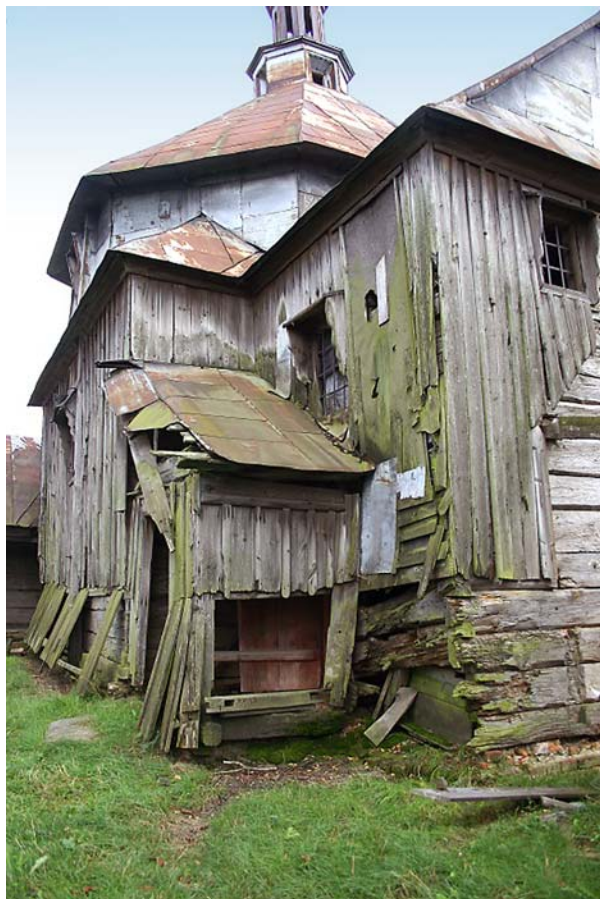
Ryc. 3. Cerkiew w Mięksiszu Starym – zaawansowana degradacja elementów zrębu ścian (stan z sierpnia 2010 r.), fot. T. Tomaszek
