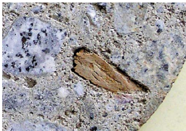
Ryc. 5. Wtrącenia drewniane, [4] Fig. 5. Wood inclusion in concrete, [4]
