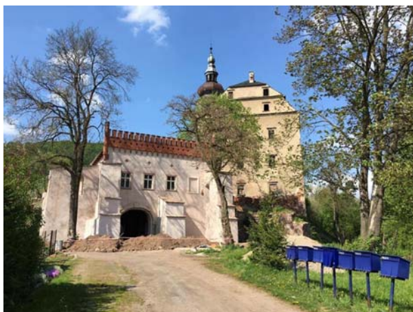
Ryc. 1. Dwór Sarny z odbudowanym krenelażem domu bramnego – widok od południowego zachodu (fot. Fundacja Odbudowy Dworu Sarny)
