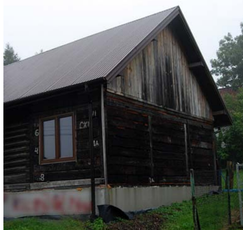
Ryc. 2. Dom jednorodzinny w Ochojnie 41, gm. Świątniki Górne – relokacja fragmentu budynku w miejsce zniszczonej części – zbliżenie – Ł. Wesółowski, 2016
