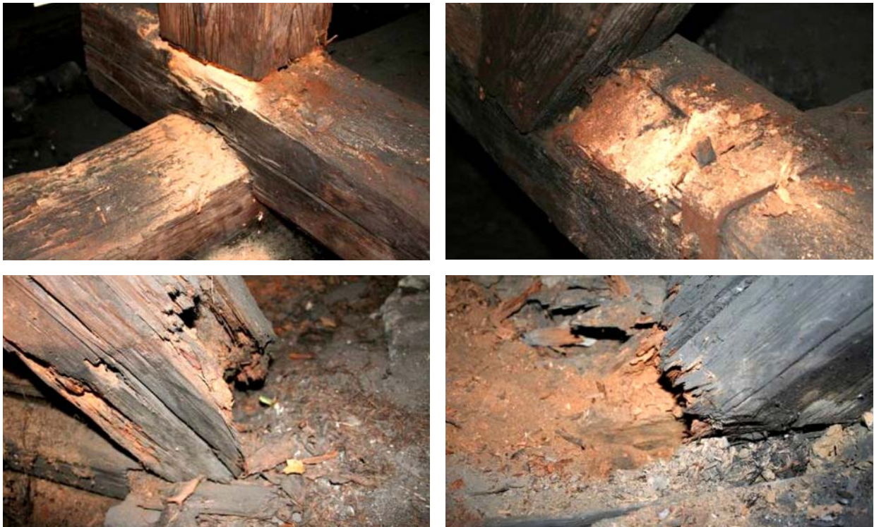
Ryc. 1. Uszkodzenie elementów więźby dachowej przez korozję biologiczną (kościół pw. św. Bartłomieja z XVII w.)
