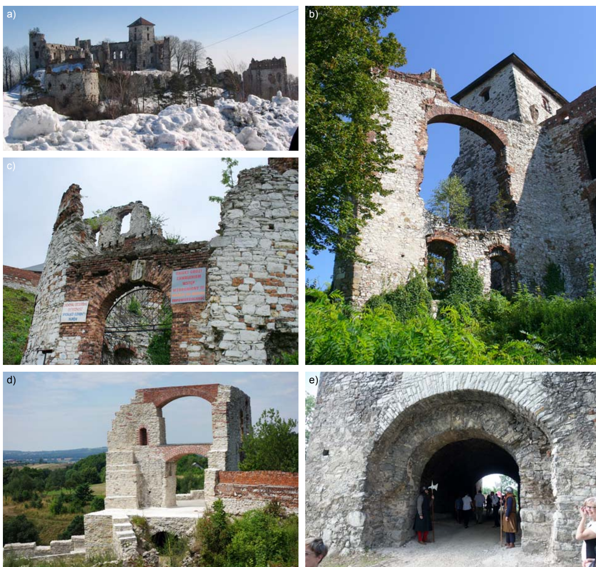
Ryc. 4. Tenczyn: a) widok zamku w 2006 r.; b) przykład prac zabezpieczających ruiny z pocz. XX w., łuk ceglany stabilizujący zagrożony filar – stan w 2009 r.; c) brama barbakanu, stan w 2008 r.; d) zabezpieczone mury skrzydła północnego, fot. z 2015 r. – skrzydło pn.; e) uroczyste udostępnienie części zamku dla turystów, 2 lipca 2016 r.
