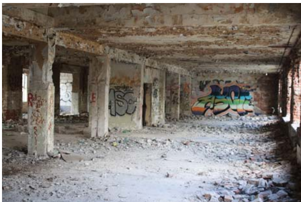
Ryc. 10. Wnętrze II kondygnacji budynku produkcyjnego, widoczne filary stanowiące podparcie konstrukcji stropu (fot. J. Dąbrowski)
