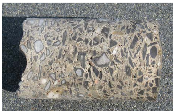
Ryc. 3. Widok struktury badanego betonu – odwiert TR-8
