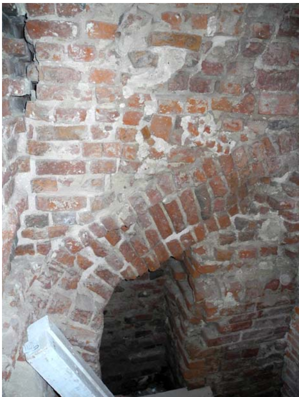
Ryc. 22. Wieża Klesza na Zamku Wysokim w Malborku. Piwnica, pomieszczenie nr 02. Narożnik południowo-wschodni. Widok na ścianę południową z szerokim, skutym łękiem, tworzącym pierwotnie sklepienie kolebkowe. Partia środkowa muru nieregularna, wtórnie wypełniona, co mogło się łączyć z jej pęknięciem. Przestrzeń poniżej sklepienia została obmurowana w momencie rozbudowy kościoła (fot. M. Prarat, 2015)
