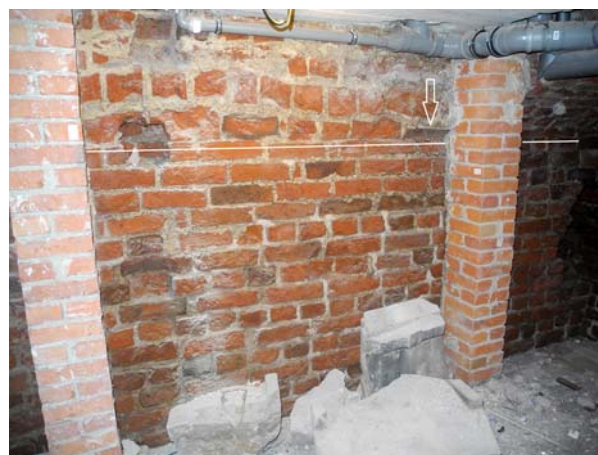
Ryc. 23. Wieża Klesza na Zamku Wysokim w Malborku. Piwnica, pomieszczenie nr 02. Ściana południowa. Widoczna granica sklepienia kolebkowego, które zostało skute (fot. M. Prarat, 2015)
