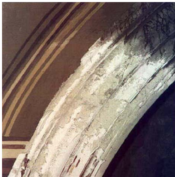
Ryc. 2. Uszkodzenia dekoracji spowodowane kondensacją pary wodnej
