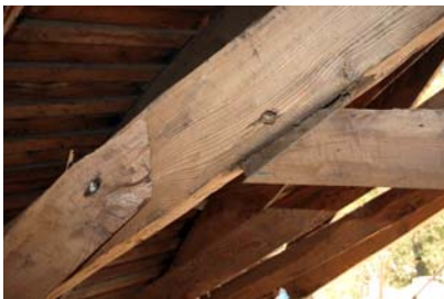
Rys. 30. Wysunięcie czopa jętki z zastrzału na skutek deformacji poziomych spowodowanych brakiem połączenia zastrzałów i krążyn z belkami stropowymi
