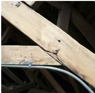
Rys. 31. Wysunięcie czopa jętki z zastrzału i uszkodzenie zastrzału na skutek deformacji poziomych spowodowanych brakiem połączenia zastrzałów i krążyn z belkami stropowymi
