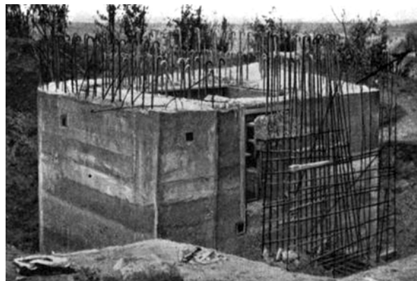
Fot. 2. Schron przed zalaniem stropu i przelotni. Źródło: Denkschrift über die polnische Landesbefestigung , Berlin 1941, str. 238–239, http://www.mapywig.org/m_documents/DE/Denkschrift_ueber_die_polnische_Landesbefestigung_1941.pdf , dostęp: 8.03.2017
