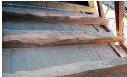
Rys. 35. Destrukcja belek stropowych nad prezbiterium
