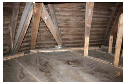
Rys. 27. Folia pokrywająca belki stropowe nad ośmioboczną nawą. Widoczne ślady przecieków przez nieszczelne pokrycie pseudokopuły Fig. 27. Membrane covering the ceiling beams over the octagonal nave. Traces of leakage through untight covering of pseudo-dome
