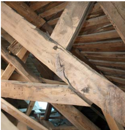
Rys. 29. Złamanie zastrzału i wysunięcie czopa jętki z zastrzału na skutek deformacji poziomych
