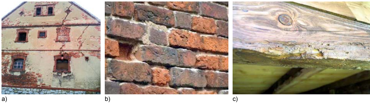
Ryc. 1. Zdegradowane fragmenty konstrukcji: a) muru, b) cegieł i zaprawy, c) drewna Fig. 1. Degraded fragments of structures: a) masonry wall, b) bricks and mortar, c) wood
