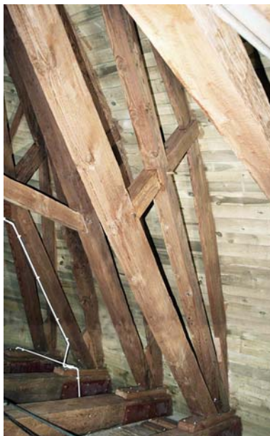
Rys. 11. Zastrzały i krążyny pseudokopuły Fig. 11. Struts and centering frames of the pseudo-dome
