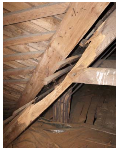
Rys. 25. Destrukcja zastrzału w więźbie nad prezbiterium Fig. 25. Destruction of strut in the roof structure over the chancel
