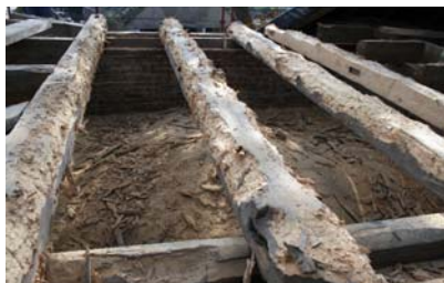
Rys. 22. Belki stropowe nad zakrystią zniszczone powierzchniowo przez owady Fig. 22. Ceiling beams over the sacristy with surface damaged by insects
