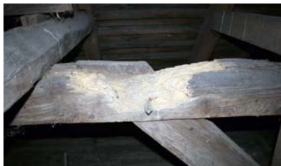
Rys. 24. Głęboka destrukcja rygla w więźbie nad zakrystią Fig. 24. Deep destruction of beam in the roof structure over the sacristy
