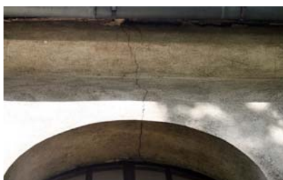
Rys. 20. Zarysowanie łuku nadokiennego w ścianie ośmiobocznej nawy Fig. 20. Cracking of window arch in the octagonal nave wall
