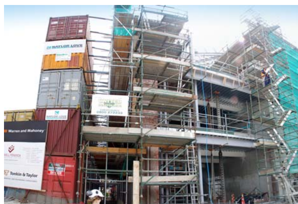
Ryc. 13. Połączenie historycznej elewacji z konstrukcją stalową i żelbetową, 2013 r. (fot. Ł. Bednarz)
