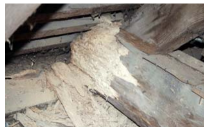
Rys. 26. Destrukcja podwaliny i belki stropowej nad prezbiterium Fig. 26. Destruction of sleeper and ceiling beams over the chancel
