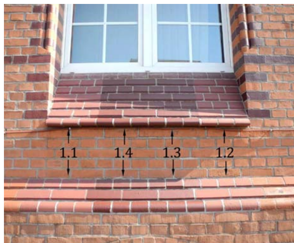
Ryc. 11. Widok elewacji po okresie zimowym (marzec 2015 r.)
