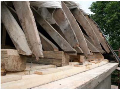
Rys. 28. Za krótkie belki stropowe. Brak oparcia zastrzałów i krążyn
