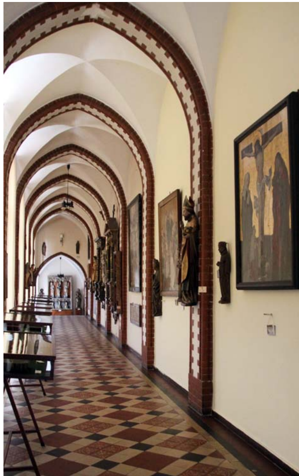
Ryc. 10. Korytarz głównego skrzydła w budynku Muzeum Archidiecezjalnego przy ul. Kanonii 12–14 we Wrocławiu. Zachowane wnętrza sklepienie krzyżowe na ceglanych gurtach, z oryginalną stolarką okienną i wielobarwnymi posadzkami z płytek kamionkowych, niezachowana pierwotna kolorystyka ścian. Fot. A. Gryglewska, 2016
