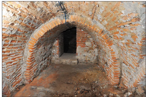
Ryc. 8. Widok podziemi bazyliki przed remontem, krypta pod północną nawą boczną; archiwum M. Piórkowskiego.
