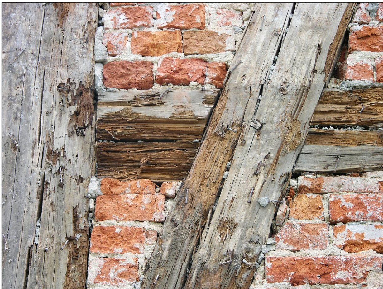
Ryc. 10. Rościślawice, kościół, nawa północna, ściana północna, wypełnienia pól szkieletu, rok 2009; fot. U. Schaaf.
