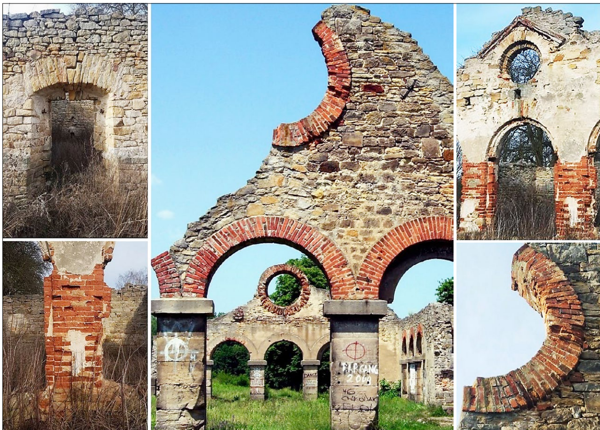
Ryc. 7. Walcownia huty żelaza w Nietulisku Dużym, stan wynikający z braku konserwacji, rok 2020; fot. M. Marchewka. Fig. 7. Iron Rolling Mill in Nietulisko Duże, extent of damage caused by a lack of conservation, 2020; photo by M. Marchewka.
