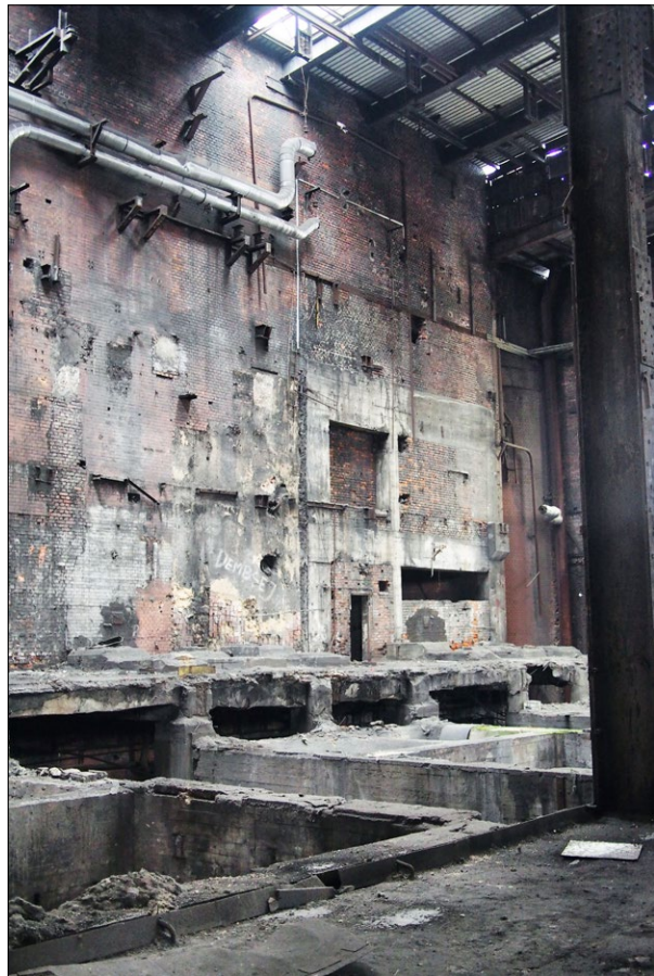
Ryc. 8. Zdeprawowane wnętrze budynku kotłowni; fot. D. Oleś 2019.
