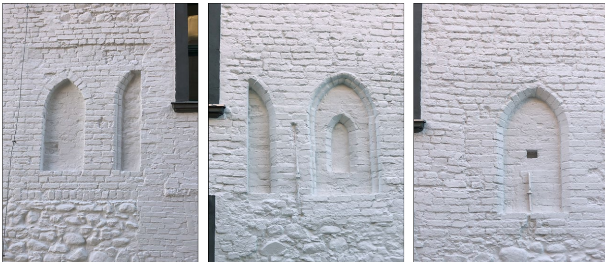
Ryc. 8 a, b, c. Elewacja północna, detale gotyckiego wystroju piętra, stan po pracach; fot. autor.
