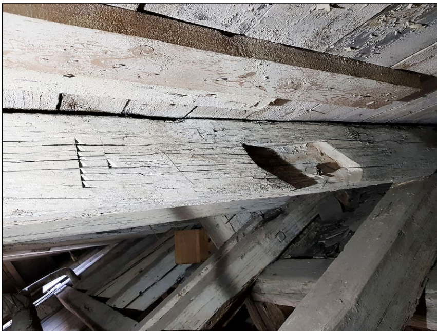
Ryc. 9. Wrocław, budynek przy ul. Szewskiej 49, więźba dachowa z 1846, wtórnie użyte elementy, krokiew z gniazdem nakładkowym i znakiem montażowym w formie trójkątów przy kresce; fot. U. Schaaf 2021.
