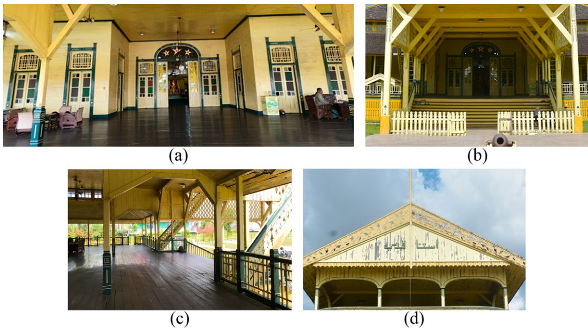
Fig. 4. The condition of non-structural elements of the Kadariah Palace; photo by N. Norita 2021. Rys. 4. Stan elementów niekonstrukcyjnych w obrębie pałacu Kadariah; fot. N. Norita 2021.
