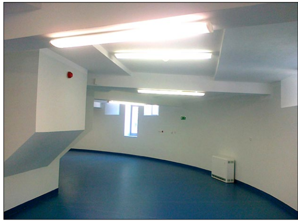
Fig. 8. Part of the ground floor after thermal retrofitting and interior finishing, 2013; photo by P. Opalka Ryc. 8. Część parteru po termomodernizacji i wykończeniu wewnątrz, 2013; fot. P. Opalka
