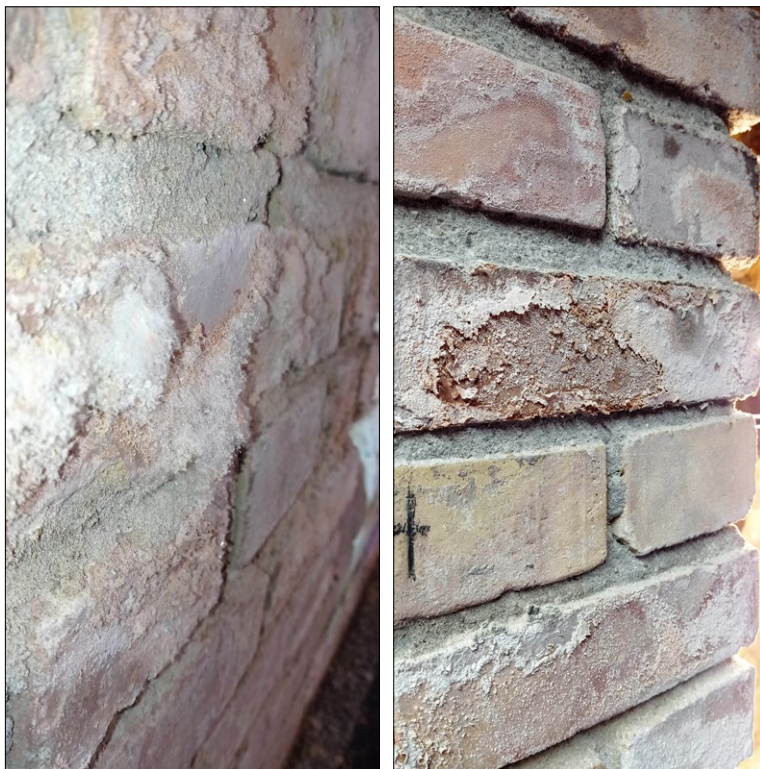
Ryc. 7. Przykładowe zasolenia muru, 2021; fot. K. Sikorski Fig. 7. Examples of salt precipitation on masonry, 2021; photo by K. Sikorski
