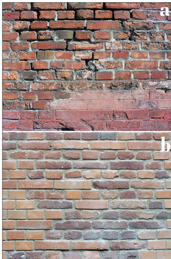
Ryc. 10. Problematiczne lica ceglaneanego muru; a – stan przed renowacją ukazujący większość typowych uszkodzeń, b – po zakończeniu prac konserwatorskich ukazujący skalę przymurowań; fot. autor
