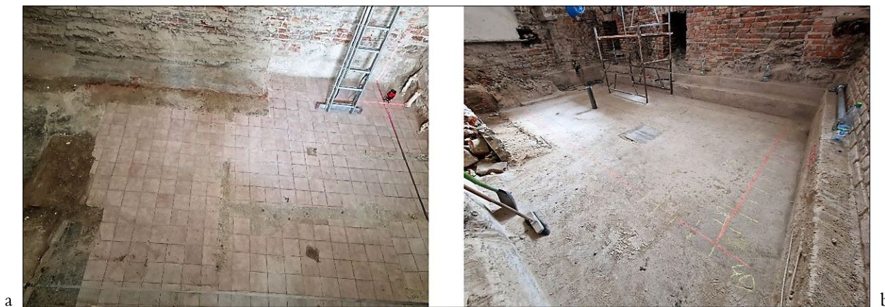
Ryc. 2. Widok posadzki w Żurawiu w Gdańsku na poziomie -1; a – baszta południowa, b – baszta północna, 2022; fot. M. Zielińska Fig. 2. View of the floor of the Crane in Gdańsk at level -1; a – south tower, b – north tower, 2022; photos by M. Zielińska
